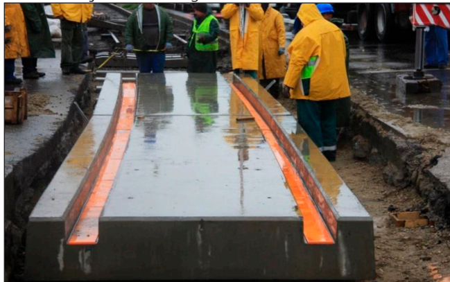
5. ábra: Útátjáró Edilonos rögzítéssel
