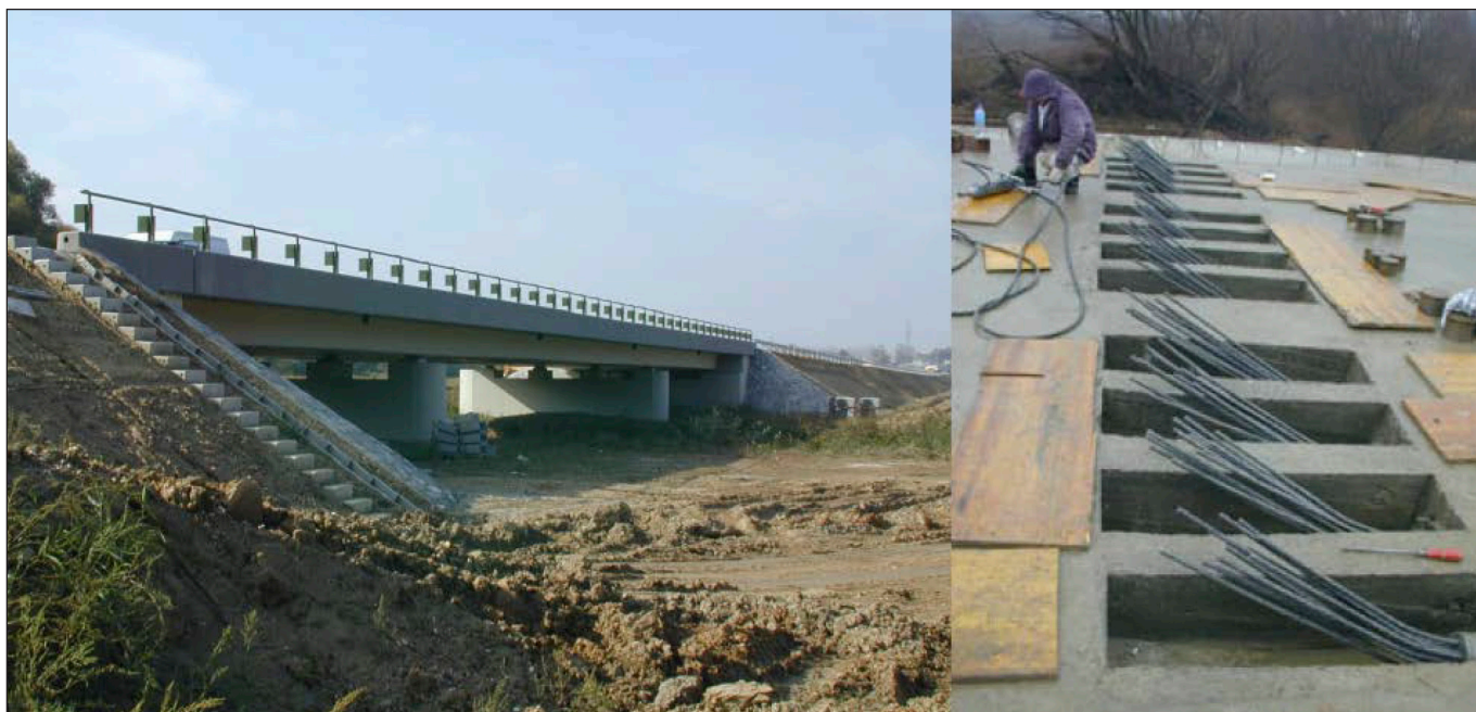
3. ábra: A első csak külső kábeles feszített híd a 74. számú főút Zalaegerszeg elkerülő szakaszán
