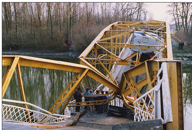
Szabálytalan jármű miatt leszakadt halászi Mosoni-Duna-híd
